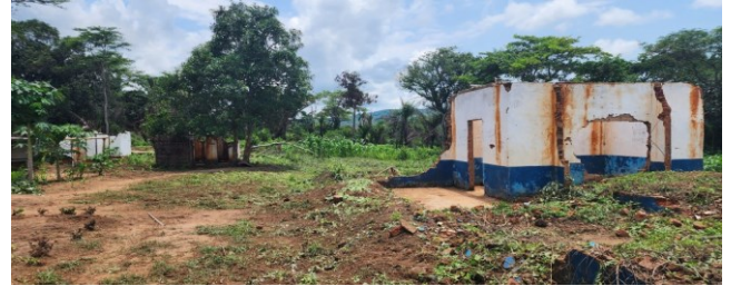
Le bâtiment du CS de Kabeya M détruit lors des conflits
