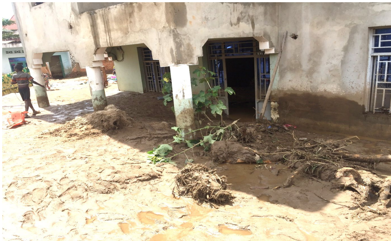
Figure 1 : Une maison inondée sur avenue plage d'or au quartier Nyamianda par les eaux de la rivière Kalimabenge.
