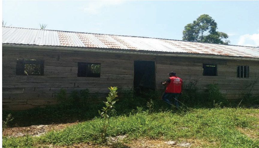
Ecole primaire Muliki (fenêtrse et porte détruite, et envahie par la brousse car inoccupée), photo HEKS du 20/05/2026
