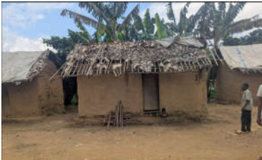
Abris délabré à Kishongya, photo HEKS 16/06/2026
