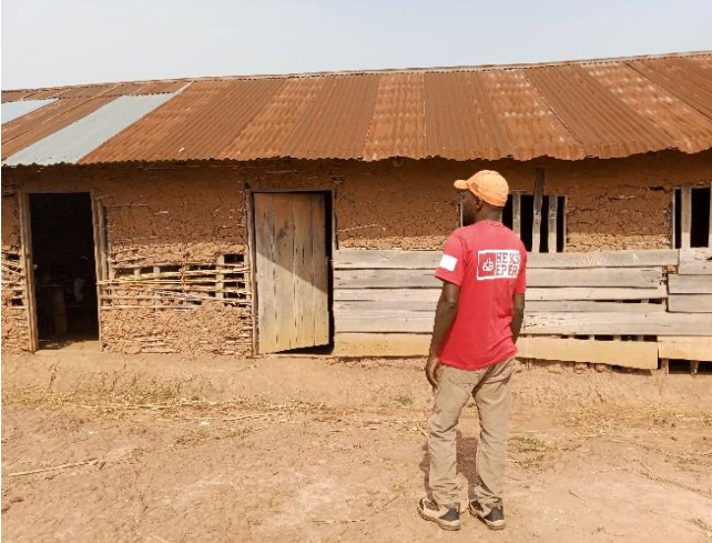
Bâtiment délabré de l'école primaire Mwekwe
