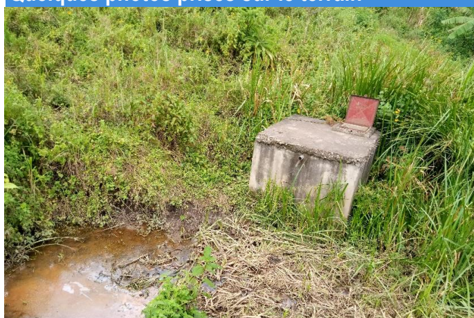
25/06/2022 (Rusamambo) : Réservoir d'eau endommagé
