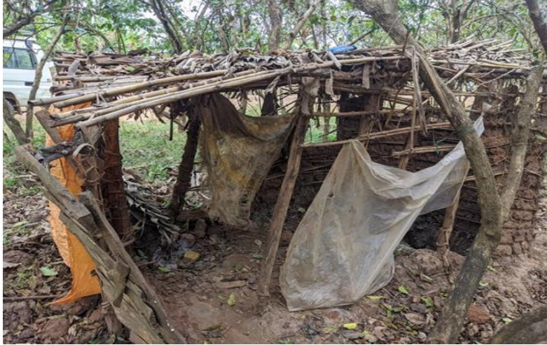
Latrine familiale à Djupukungo
