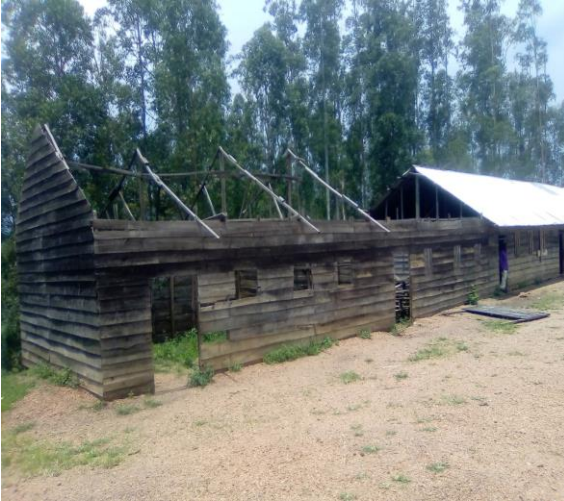
Bambo (02/09/2022) : Bâtiment de l'Ecole Lunga Primaire dont la toiture a été emportée par la tempête depuis 2021
