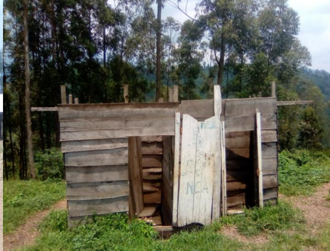
Bambo (02/09/2022) : Latrine endommagée de l'EP Lunga
