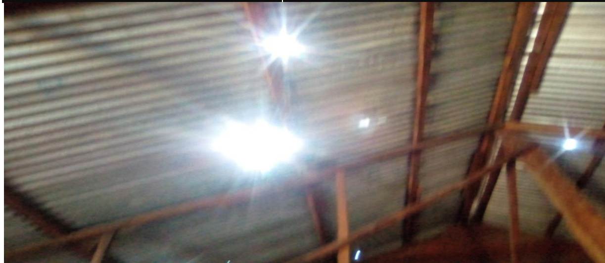
Bambo (02/09/2022) : Toiture de l'Ecole Primaire endommagée par des impacts des balles depuis 2021
