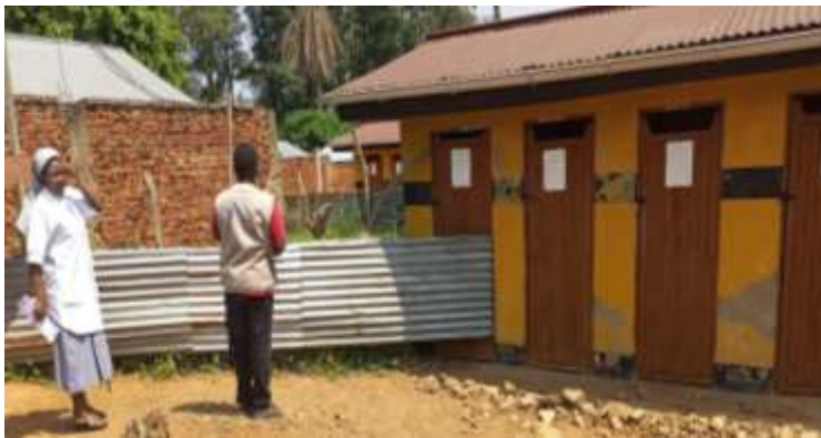
Latrine non utilisable au CSR Mangina à cause de la fosse septique mal construite
