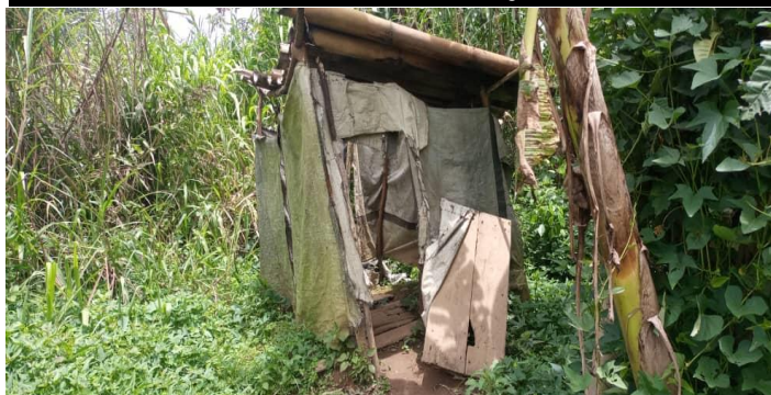
16/03/2022 : Une latrine familiale en état de délabrement
