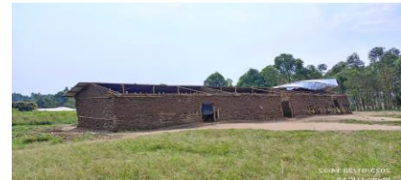
Toiture de EP Katsu emportée par le vent
